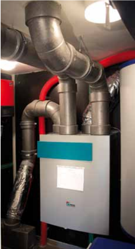
ventilatie-unit, aan en afvoer
