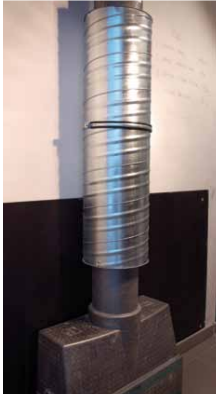
demper op ventilatiekanaal
